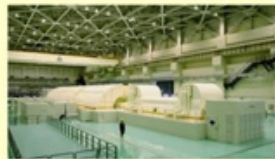
● 中部電力(株) 浜岡原子力発電所第5号機 (2005) (タービン設備)
