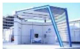
水素ステーション
