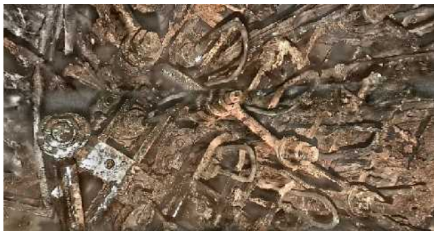
CRDハウジング (グレーチング脱落部真上)
