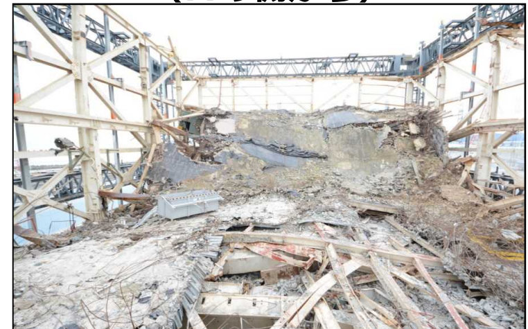
南側の崩落屋根状況(Aの側から)
