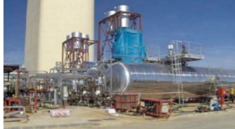
太陽熱による熱水貯蔵プラント(Nevada, USA)
